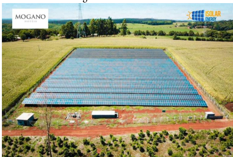
Figura 3 – Usina de Energia Solar
