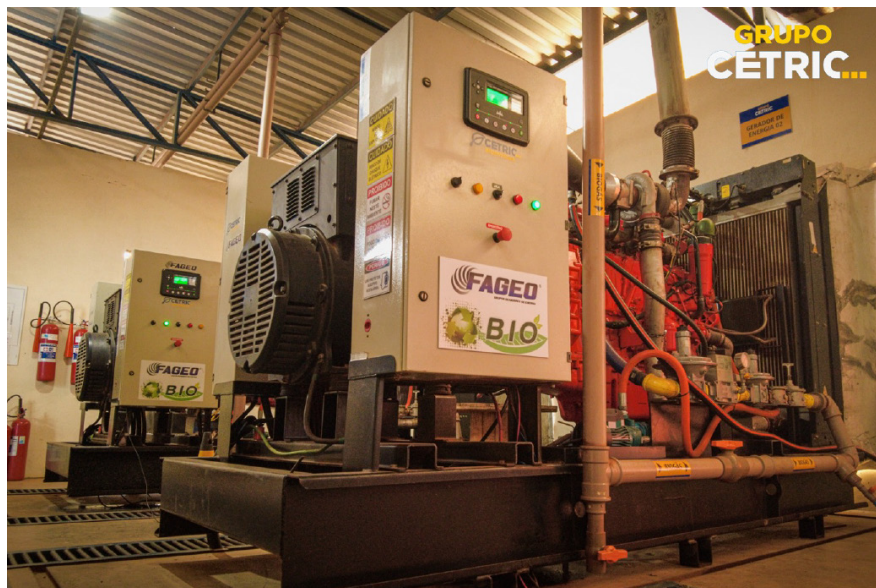
Figura 2 – Geradores de energia
